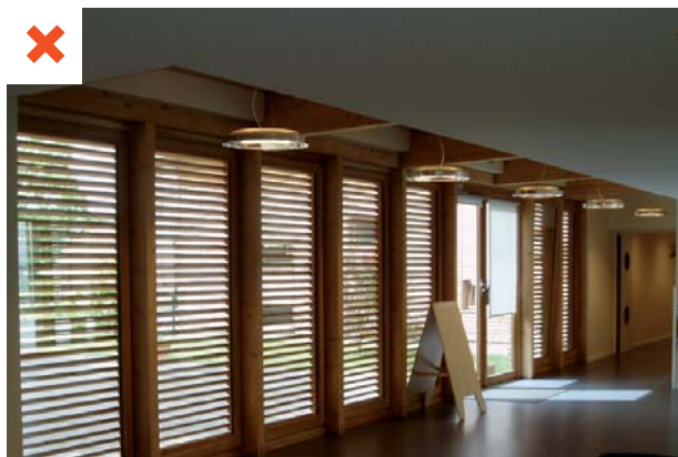
Projet 2 – Surdimensionnement des brises soleil – Hall d'entrée. ©AQC
