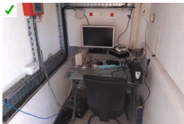
Plateforme de GTC/suivi des consommations. ©AQC
