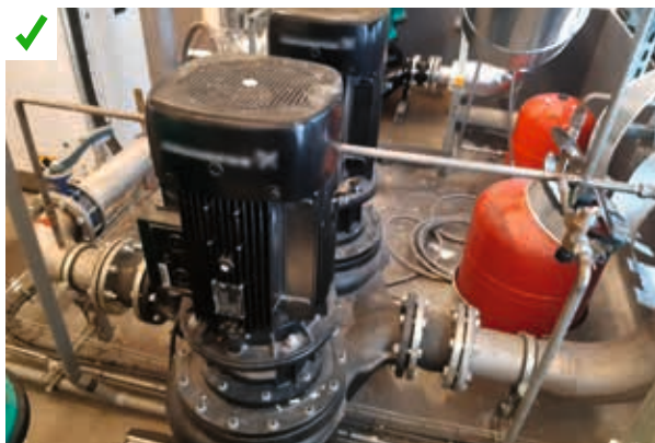
Pompes à débit variable. ©AQC
