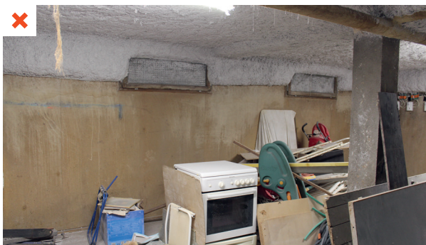
Les soupiraux de ce sous-sol ont été obstrués par de l'isolant projeté lors de l'opération d'isolation du plancher bas. ©AQC
