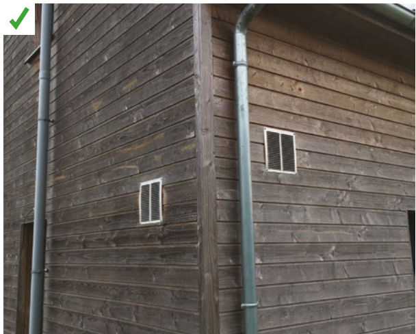
À défaut de pouvoir installer le rejet d'air vicié en toiture, la prise d'air neuf et le rejet d'air vicié sont situés sur deux façades différentes de la maison, ce qui empêche la re-circulation de l'air vicié dans le bâtiment. ©AQC
