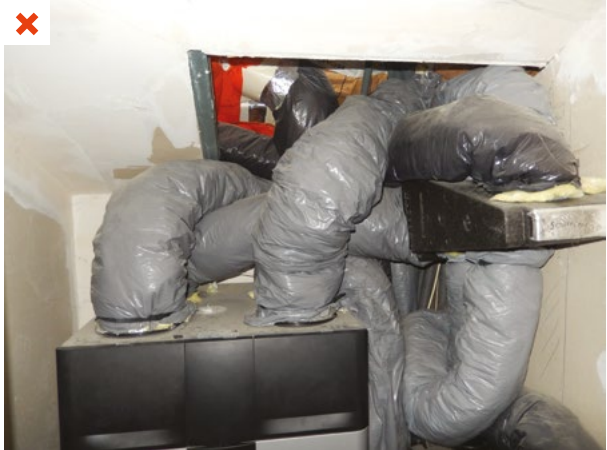
Des coudes et des écrasements de gaines souples sont présents à proximité immédiate de la CTA ce qui engendre des pertes de charges importantes. ©AQC
