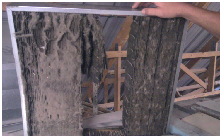
Illustration 8 – L'absence des filtres des VMC peut conduire à la rupture de ces derniers (dégradation de la qualité de l'air, risques pour les ventilateurs...).
