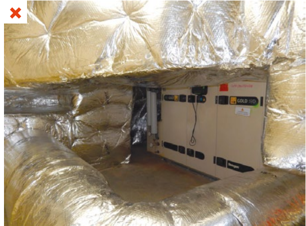
Le cheminement et l'encombrement du réseau aéronautique empêchent un accès aisé à la CTA. ©AQC
