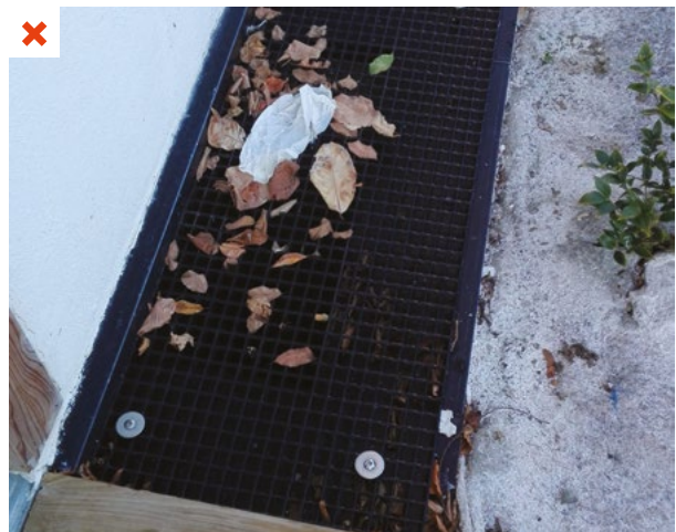
La prise d'air neuf au sol est obstruée par des feuilles et débris. ©AQC
